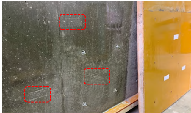
型枠取外し後の RFID センサー貼付箇所のコンクリート表面
